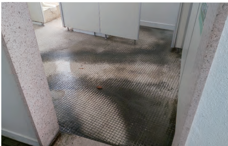
▲1日も早い改修が待たれる船客待合所トイレ
