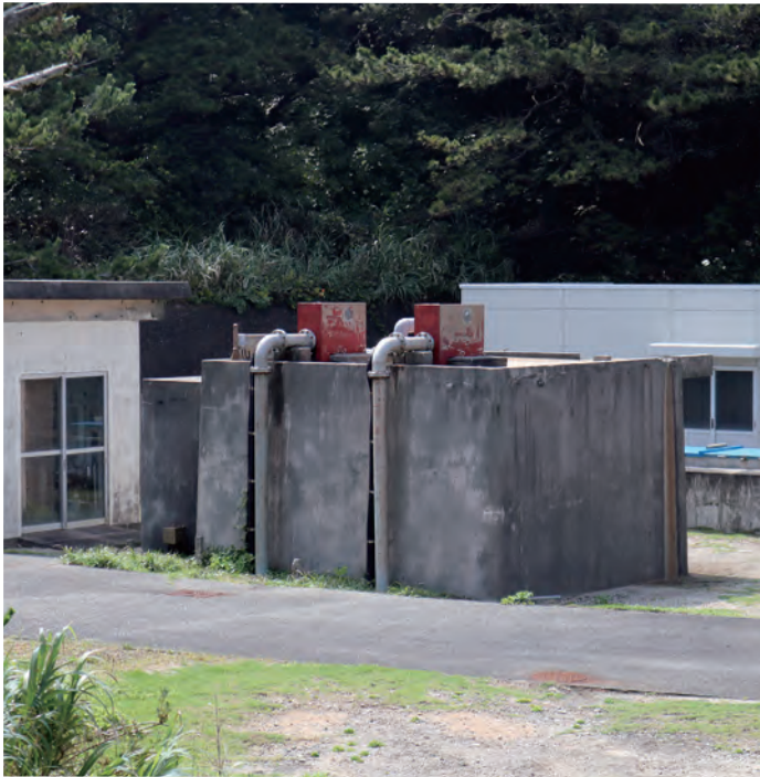
▲簡易水道 海底送水式根島貯水池の様子
